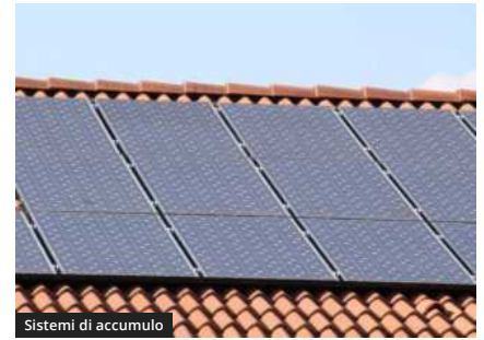
Sistemi di accumulo
